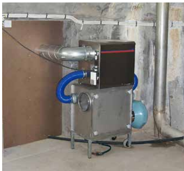
DT400 med kondensator installert i vannverk.
