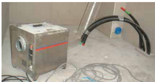
Avfukter i nybygg.
